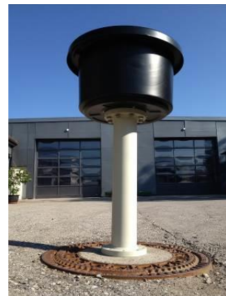
Passiv luftning av rörledning.
